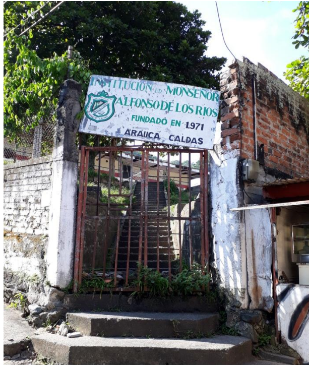
Fig 11. Puerta Auxiliar a convertirse en ruta de evacuación.
