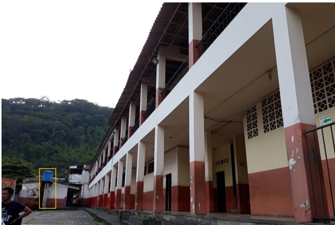
Fig 15. Patio Bloque 2 con evidencias de deterioro en zonas duras y en los tanques de agua.
