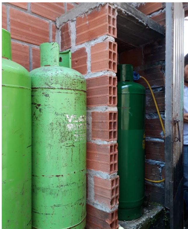
Fig 22. Depósito de pipas de gas expuesta a vndalismo o riesgo antrópico.
