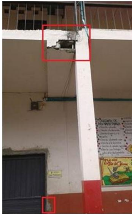
Fig 3. Daño estructural de la viga.
