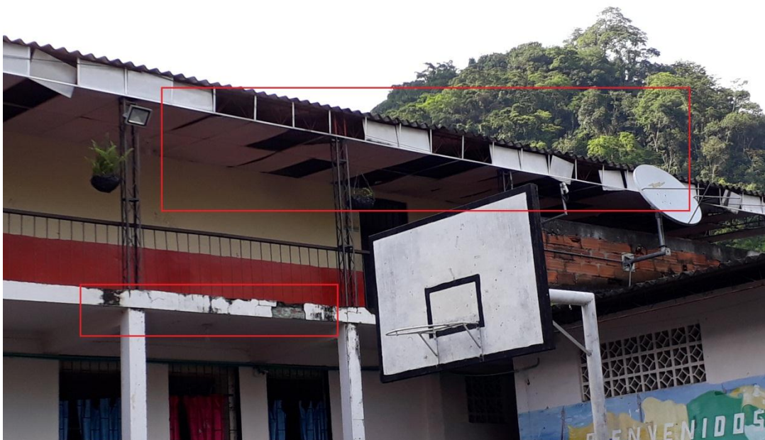
Fig 17. tejados en mal estado y pisos del segundo piso con necesidad de mantenimiento
