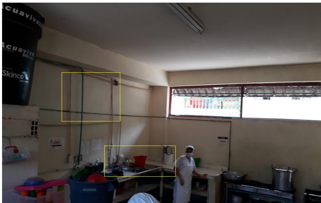
Fig 16. Cocina, red de gas y eléctrica expuesta, cocina parcialmente en acero inoxidable, riesgo biológico.
