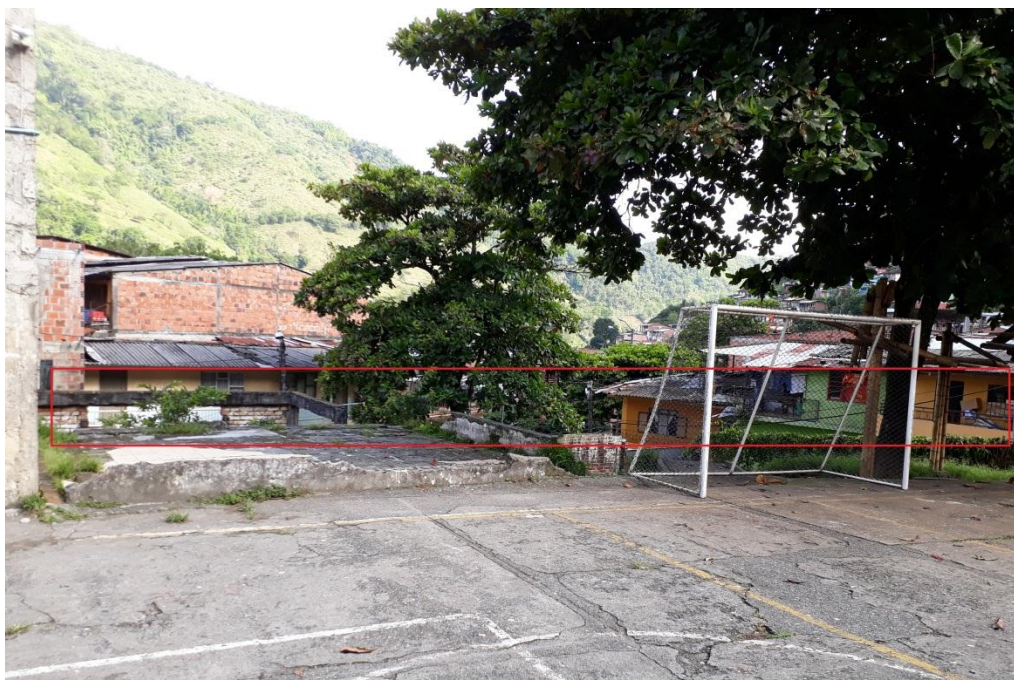
Fig 23. Ausencia de Cercamiento o cerramiento de los limites del colegio y deterioro de las zonas duras del patio del bloque 1.
