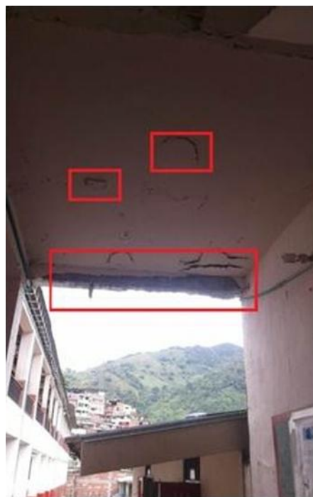
Fig 7. Plancha segundo piso. Zonas agrietadas
