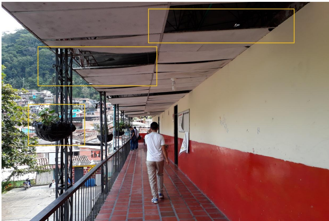
Fig 14. corredor segunda planta, techo falso en mal estado y plantas con necesidad de reforzamiento en sus estructuras
