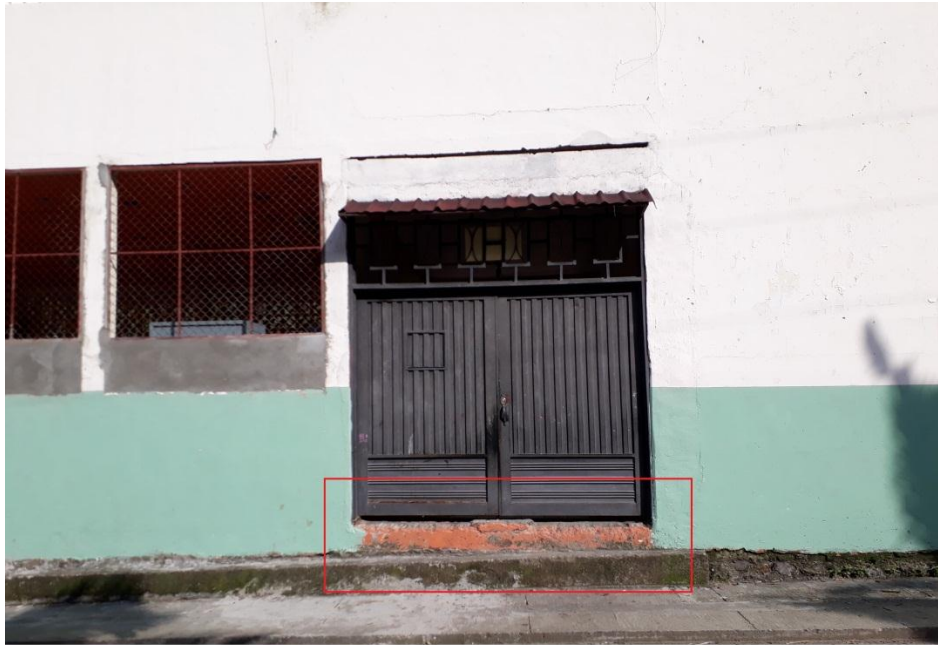
Fig 13. Entrada secundaria utilizada para preescolar, transición y primaria, en mal estado zonas duras, interiores y exteriores.
