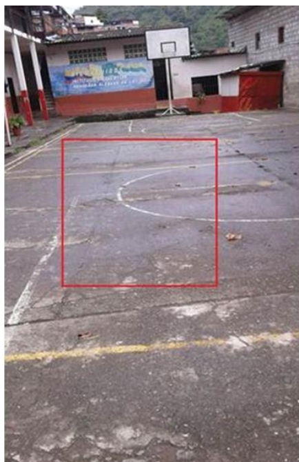
Fig 5. Patio 1. Cancha con zonas duras desgastadas, no acta para la recreación y deporte.
