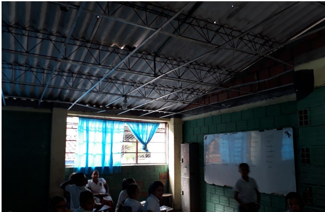
Fig 24. salones segundo piso, necesidad de mantenimiento de tejado y techo falso, además de problemas de ventilación debido a las ventanas.
