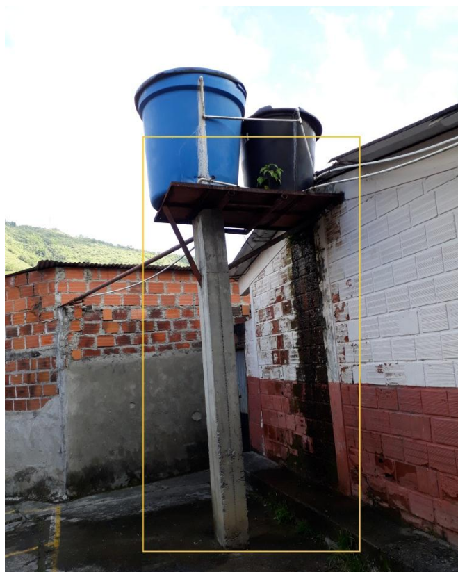
Fig 18. Ruptura de los tanques de reserva de agua y humedad en las paredes aledañas a los baños femeninos
